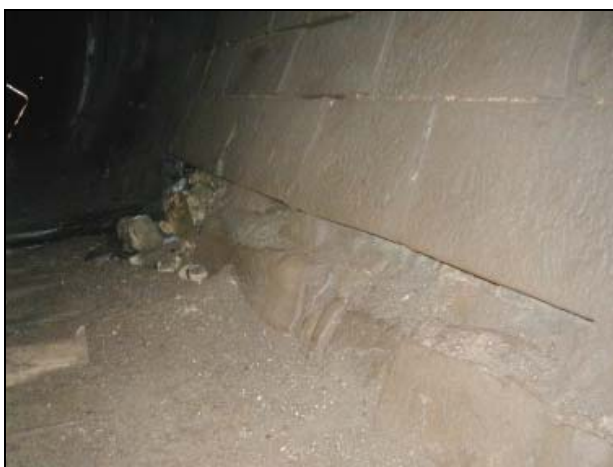
ČÁSTEČNĚ ROZPADLÉ/ERODOVANÉ ZDIVO V ZÁKLADU
